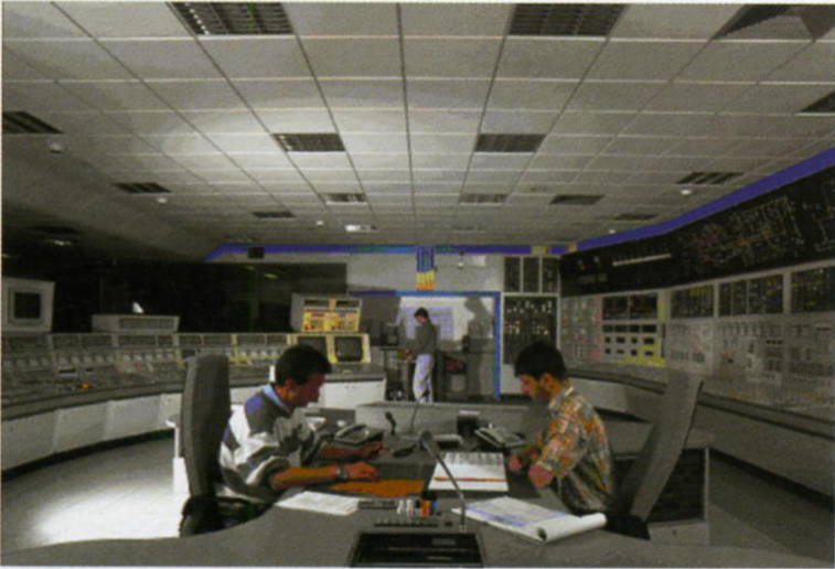
Photo 1 - Salle de commande 900 MW
