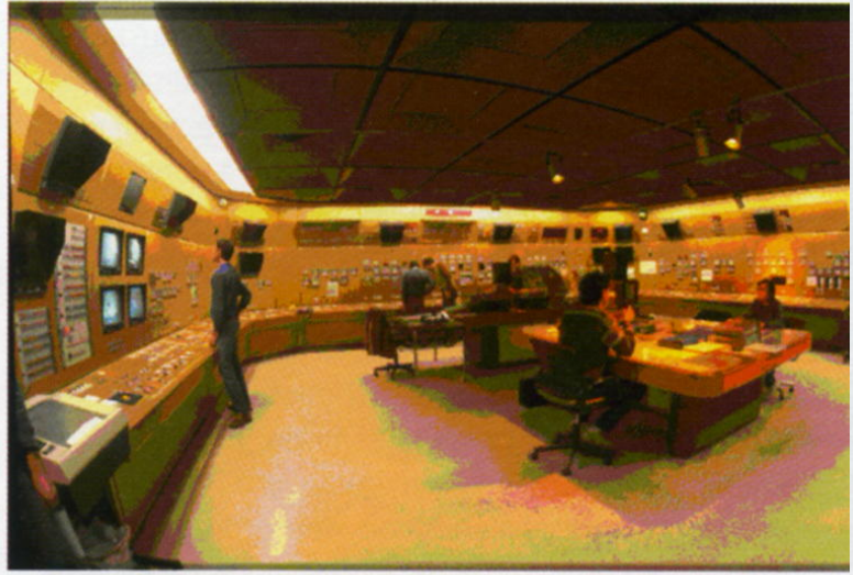
Photo 2 - Salle de commande 1300 MW
