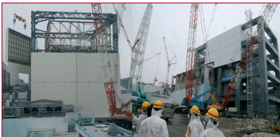
Fig. 1 Nouvelles enceintes de confinement en cours de montage Réacteur N°1 : terminé en octobre 2012 Piscine réacteur N°4 : terminé en octobre 2013
